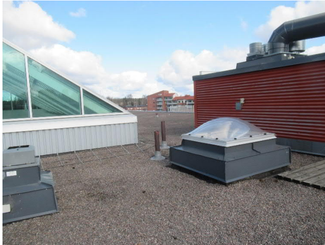
Kuva 3.5.1: Kermikatteen uusimisen arvioidaan ajoittuvan tarkastelujakson loppupuolelle. Samalla ehdotetaan lasikateosa perusteellisesti kunnostettavan.
