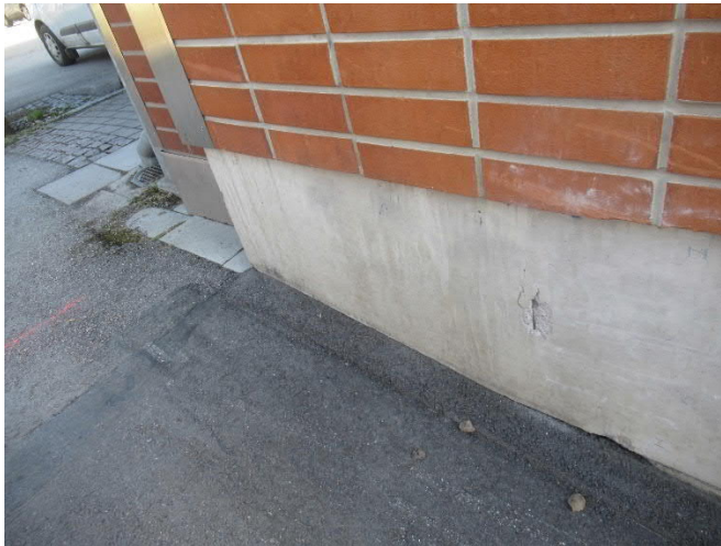
Kuva 3.2.1: Perusmuurin paikallinen lohkeama. Perusmuurien kunto on syytä tutkia suositellun kuntotutkimuksen yhteydessä.
