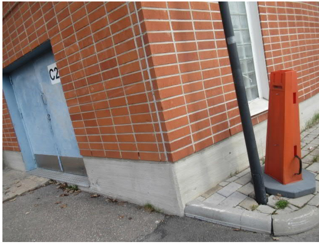
Kuva 3.1.1: Asfaltti- ja kivityspäällysteiden paikallisiin kunnostuksiin on aiheellista varautua tarkastelujakson alkupuolella.
