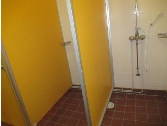
Kuva 3.6.3: Kohteen kellarikerroksen sosiaalitilojen suihkutilojen pinnat ovat ikääntyneitä ja uusimisen tarpeessa.
