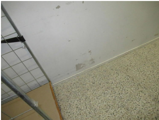
Kuva 3.6.2: B1-sisäänkäynnin käytävällä paikallista seinäpintojen kulumaa.
