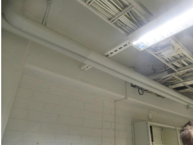
Kuva 3.3.1: Kohteen paloläpiviennit on syytä käydä läpi, tarkastaa ja tarvittaessa tiivistää. Kuva kirjasto-osan kellarikerroksesta.
